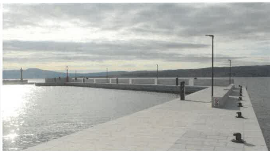
Izgled novopostavljenje LED rasvjete na sekundarnom lukobranu u studenom 2021.
