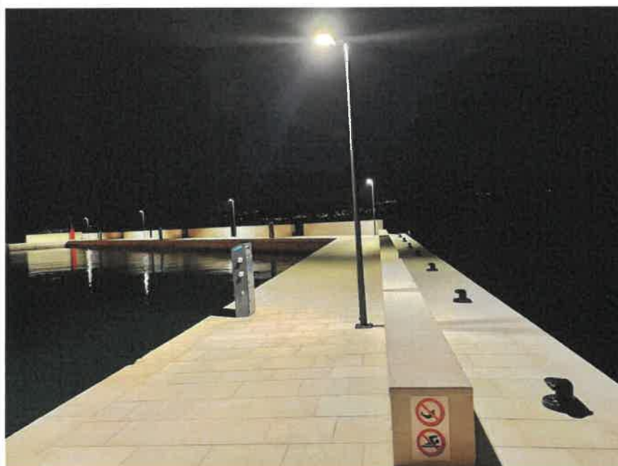
Izgled novopostavljenje LED rasvjete na sekundarnom lukobranu u studenom 2021.
